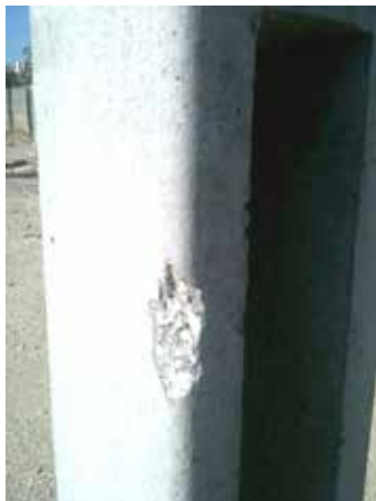
Foto 1 - Identificação da zona danificada do Poste
