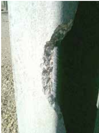
Foto 1 - Identificação da zona danificada do Poste
